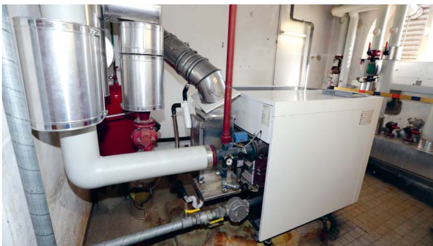
Heizzentrale altes Schulhaus
